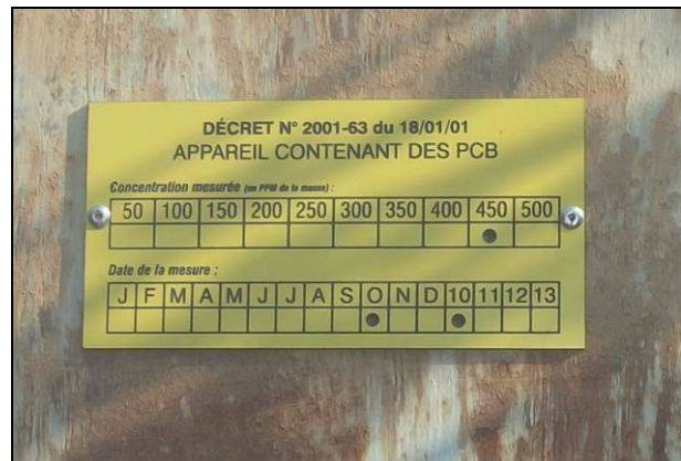
Photographie 12 : Affichage sur le transformateur indiquant la présence de PCB
