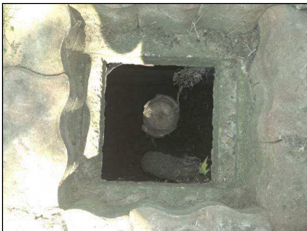
Photographies 15 : Réservoir FOD enterré (capacité inconnue)
