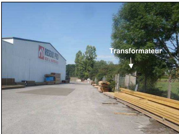
Photographie 11 : Stockage de bois traités au Nord du site et emplacement du transformateur au PCB
