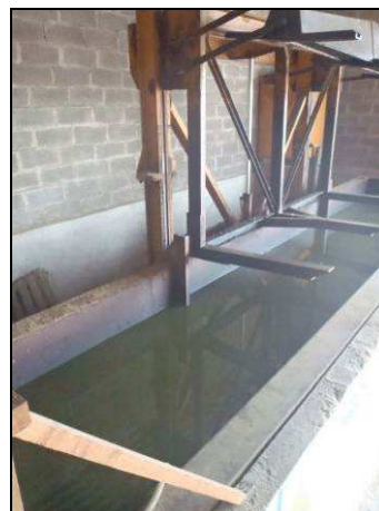
Photographie 4 : Bac de traitement dans sa rétention béton (août 2011)
