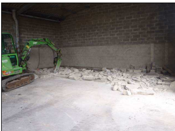
Photographie 7 : Démolition de la dalle béton sous l'ancien bac de traitement (16 juillet 2013)
